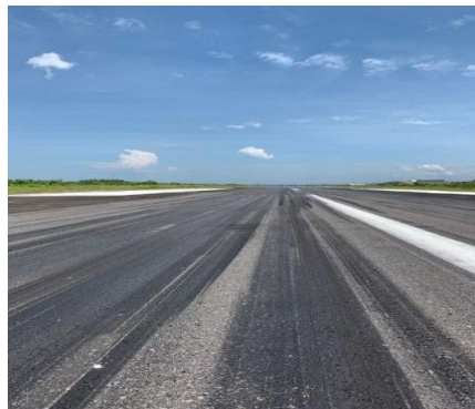
Gambar 2. Rubber Deposit Pada Runway Bandara Fatmawati Soekarno (Sumber: dokumentasi peneliti, 2021)
