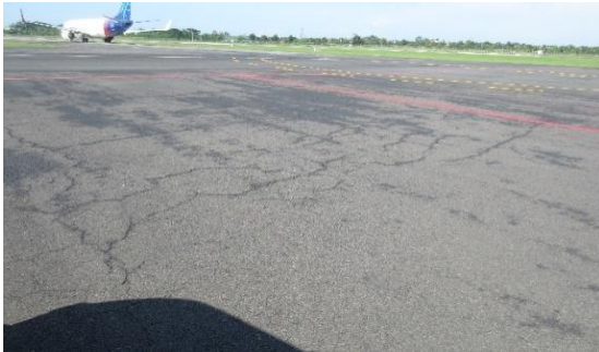
Gambar 3 Kerusakan retak blok (Sumber: Perencanaan Pemeliharaan dan Perbaikan Sisi Udara Bandara Internasional Ahmad Yani Semarang)
