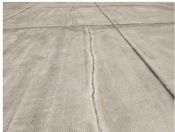
Gambar 5 Kerusakan longitudinal / transversal cracking (Sumber: PT. Angkasa Pura II)
