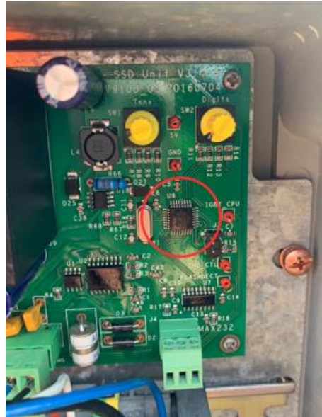
Gambar 2. Kerusakan Pada Modul Sequence Flashing Light
