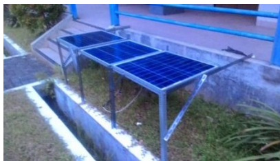
Gambar 8. Pengujian Panel Surya
