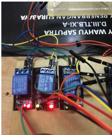
Gambar 7. Pengecekan Relay Module
