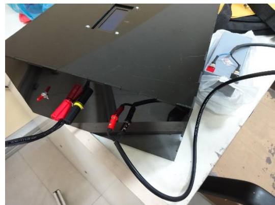
Gambar 7. Socket Baterai dan Solar Panel
